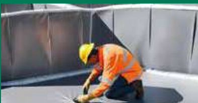
Área de contención secundaria
