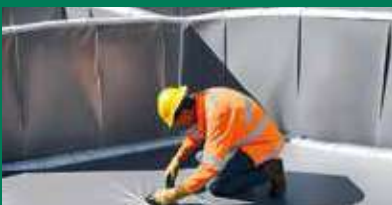
Área de contención secundaria
