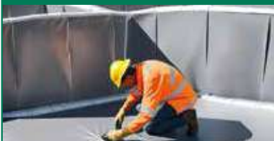
Área de contención secundaria
