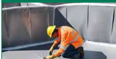
Área de contención secundaria
