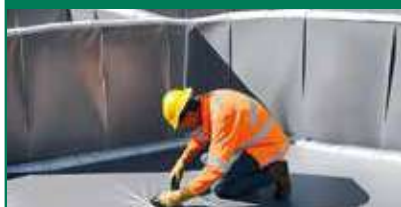
Área de contención secundaria
