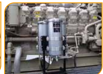
■ Compresor de gas
